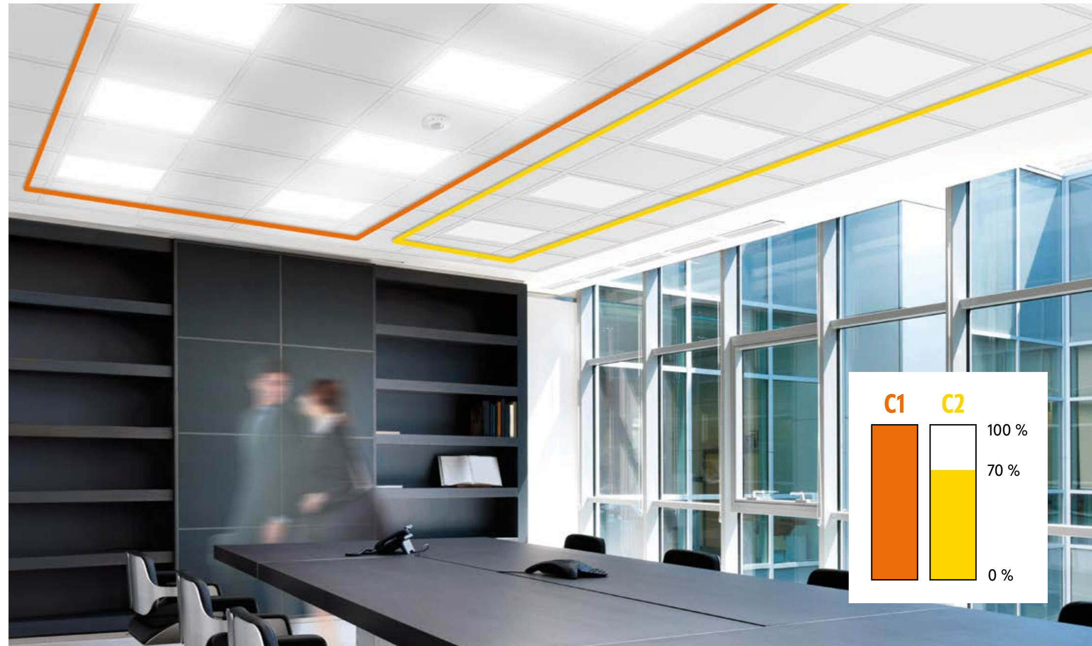
Afb. 3: Met een eenvoudige offset kan het daglichtgebruik van de constante lichtregeling verder worden geoptimaliseerd, zelfs als er maar één aanwezigheidsensor in de ruimte is. ▲
